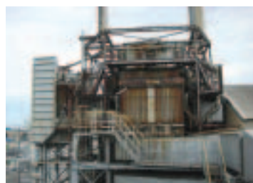
重油ボイラー
