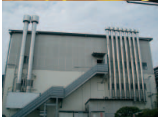
新たに稼働した第一ボイラー室
