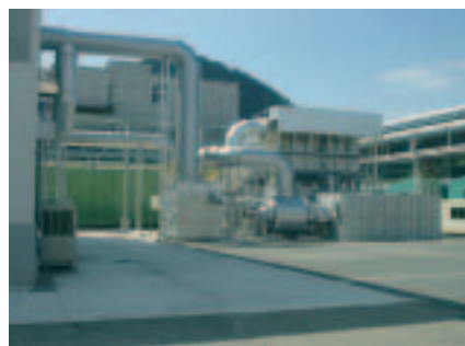
RTO (排ガス燃焼施設)
