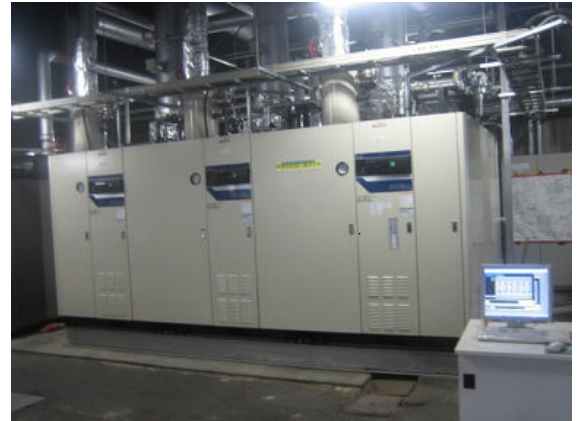
日本理化学紙 LNG ボイラー
