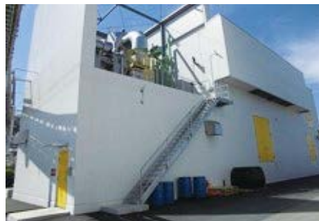
煙突跡地に設置された新設備
