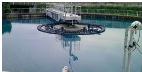
排水処理施設
