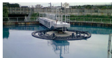
排水処理施設
