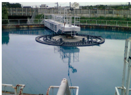
排水処理施設
