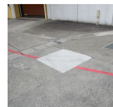
構内道路凹凸部の舗装
