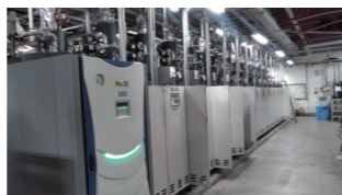
ガスボイラー
