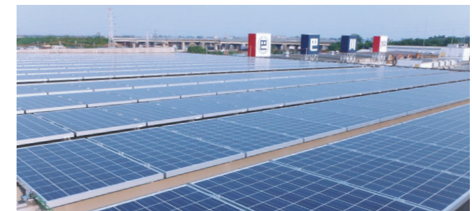
工場屋上の太陽光パネル
