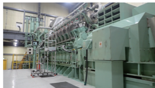
コジェネレーションシステムの全景
