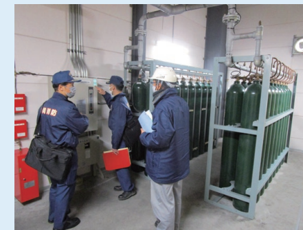
2023年2月 静岡市消防局 二酸化炭素消火設備立会確認の様子
