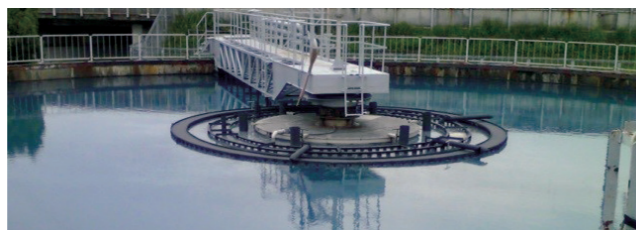
排水処理施設
