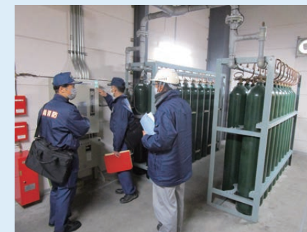
2023 年 2 月 静岡市消防局 二酸化炭素消火設備立会確認の様子
