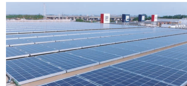
工場屋上の太陽光パネル
