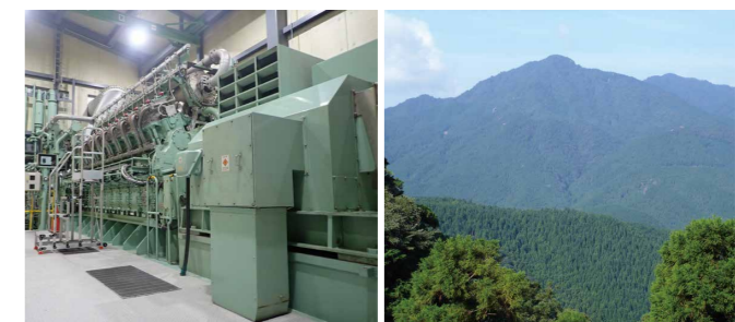
コジェネレーションシステム
